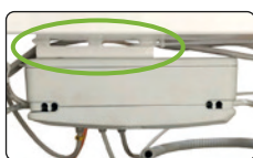
Ledninger ført bag Port-udvidelsesboksen/Fordelerboksen og ophængt med strips.
